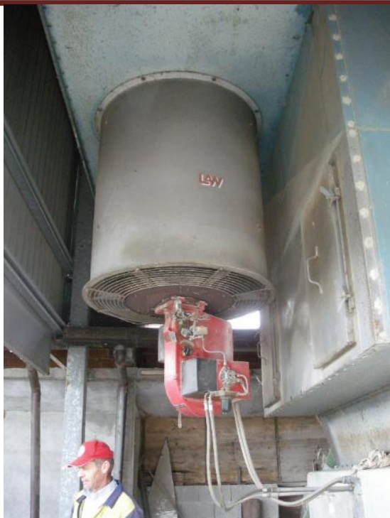
Foto 9: il bruciatore dell'essiccatoio a fuoco diretto
