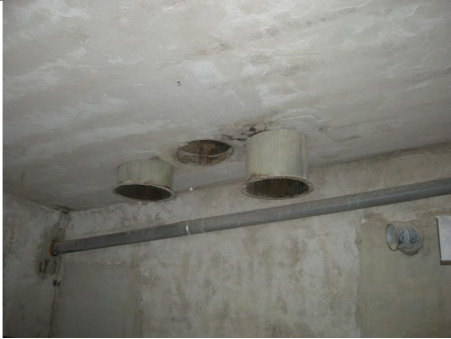
Foto 7: L'ingresso dei 3 condotti della fumana essiccatoio nella stanza di depolverazione
