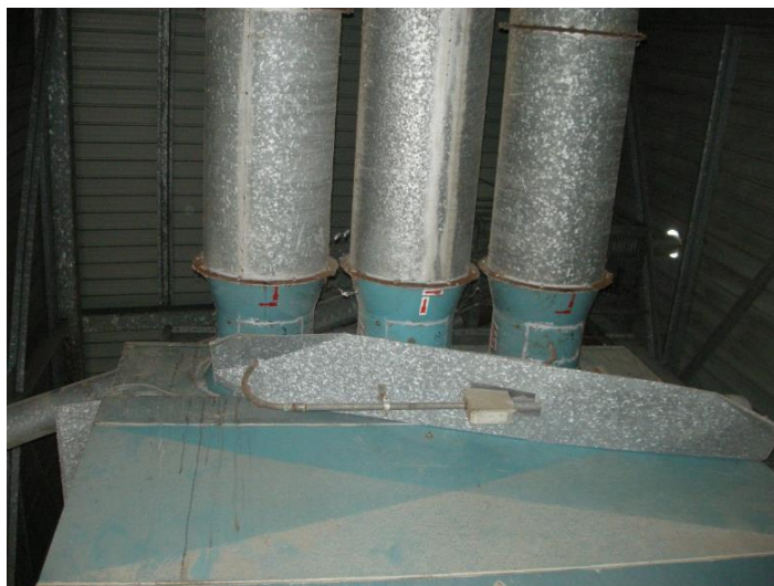
Foto 10: i tre condotti della fumana dall'essiccatoio ripresi da terra
