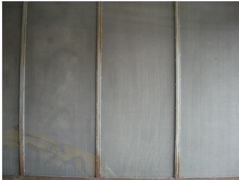
Foto 8: la rete di filtrazione dell'aria presente sulle aperture per la fuoriuscita dell'aria dalla sala delle polveri
