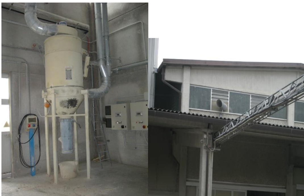
Foto 3: Il filtro a maniche che tratta l'aria in uscita dal ciclone, ben visibile lo scarico di fondo per la raccolta delle polveri ed il condotto che sale verso l'alto
